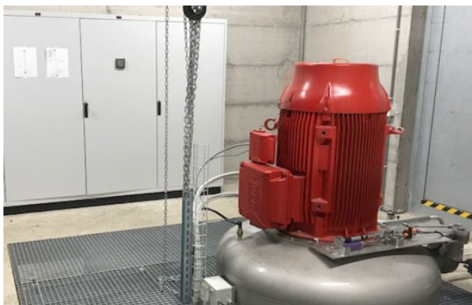
Gegendruck-Pelton turbine in Challand (Foto: DransEnergie SA)
