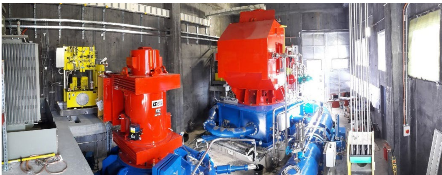
Die beiden Turbinen/Generatoren im Kraftwerk La Delise (Foto: Drans Energie)
