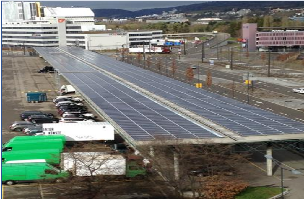
Abbildung 3: 435kWp Solarstromkraftwerk auf dem Zürcher Engrosmarkt. Der Grundeigentümer beliefert rund 66 eingemietete Firmen mit Solarstrom.
