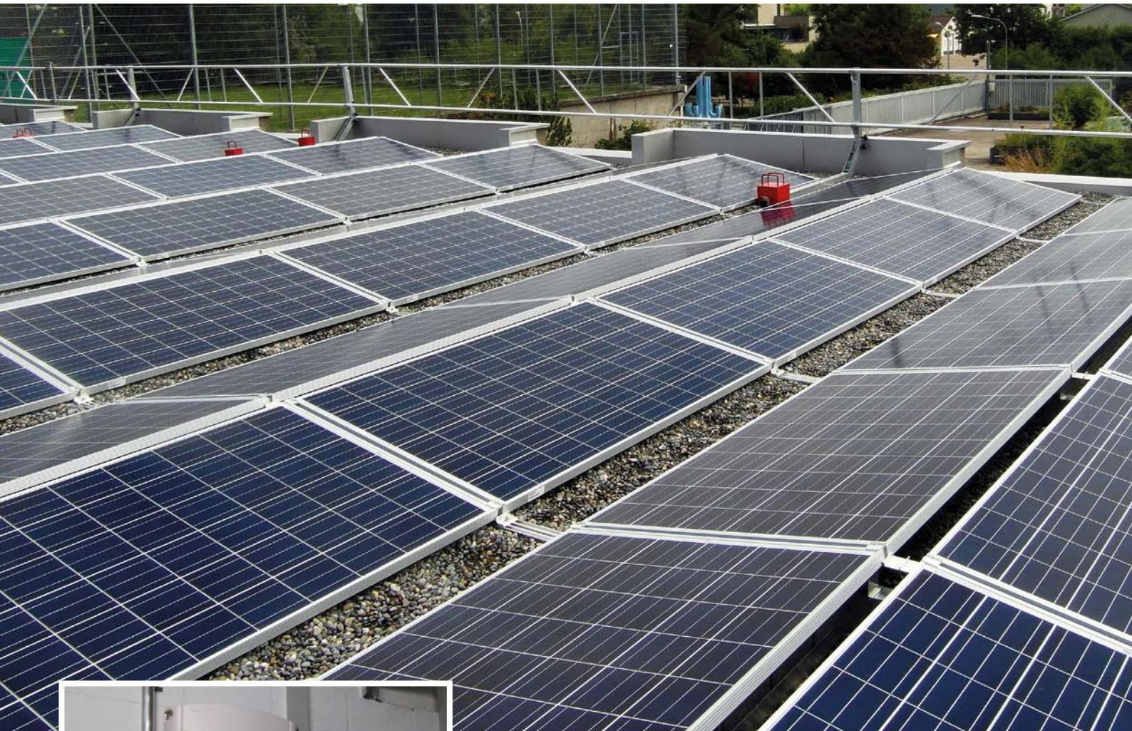
Solarmodule mit Ost-/Westausrichtung auf einem Flachdach
