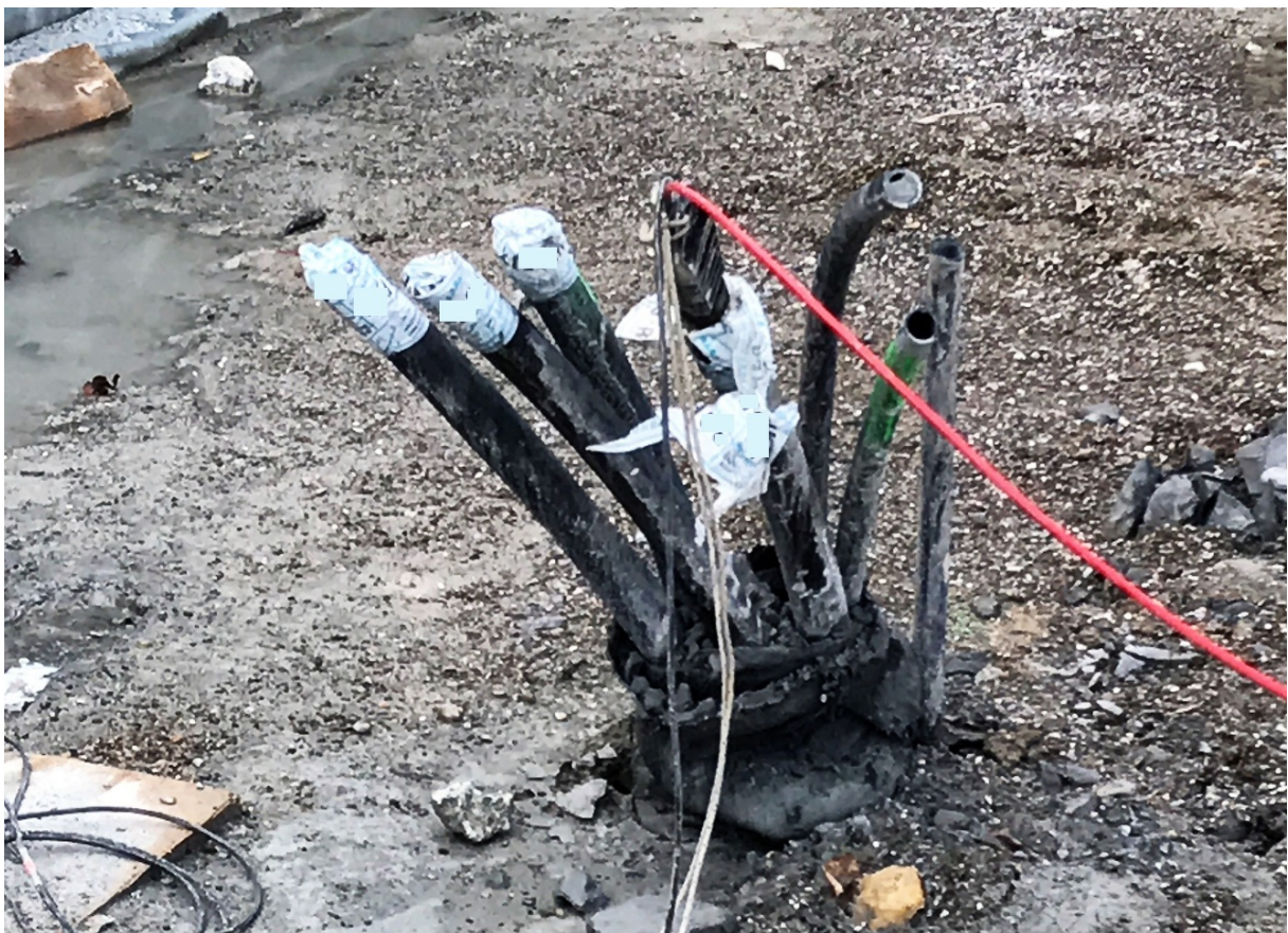
Abb. 14: Detailaufnahme des Erdwärmesondenkopfes von EWS 8. Die Sondenrohre sind durch Klebeband geschützt, rechts davon sind zwei Verpressschläuche zu sehen.
