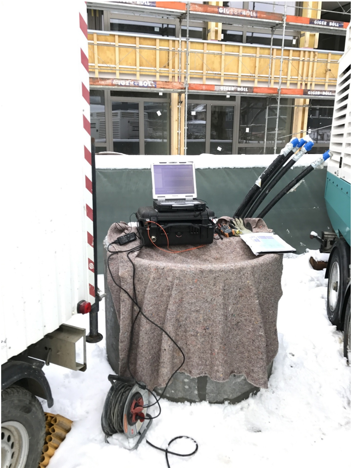
Abb. 8: Messaufbau des Kurz-EGRT von EWS 10 (Aufnahme vom 11.01.2017). Das Hybridkabel ist hier fest im Hinterfüllmaterial installiert. An diesem Kabel wurde auch im Dezember 2015 ein EGRT durchgeführt.
