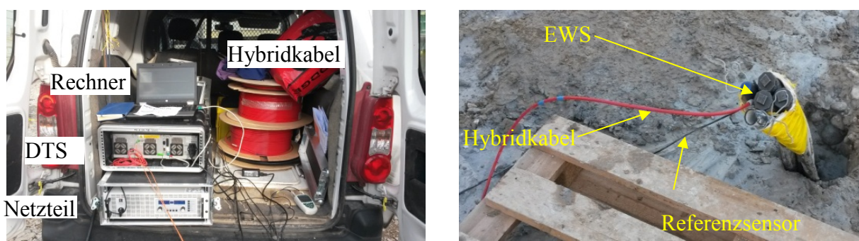
Abb. 5: Messaufbau (links) und EWS-Sondenrohre mit Hybridkabel (rechts), Beispielbilder
