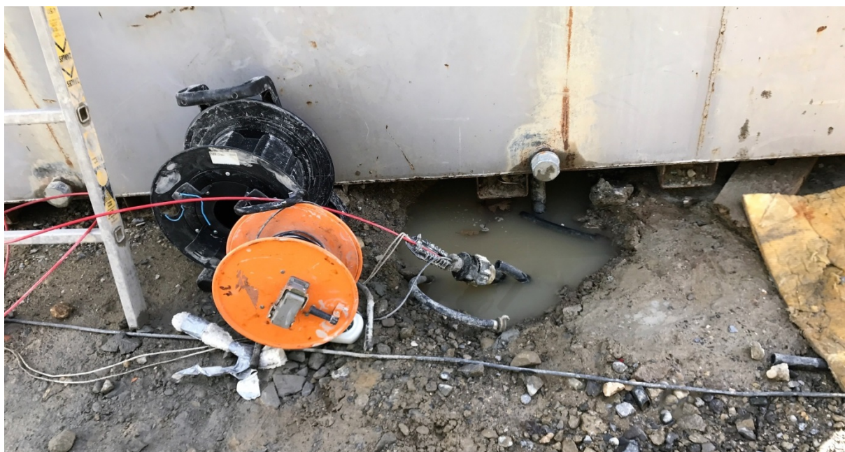
Abb. 12: Erdwärmesondenkopf von EWS 11. Zugänglich war nur eines der Sondenrohre das mit einem Adapterverschluss geschützt war; die anderen drei Sondenrohre waren unter den Container gebogen. Die Messung wurde daher in einem anderen Sondenrohr als in der vorangegangenen Messung vom 9.01.2017 durchgeführt.
