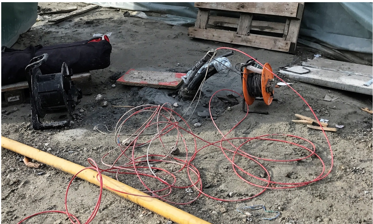
Abb. 16: Detailaufnahme des Erdwärmesondenkopfes von EWS 7. Die Sondenrohre sind durch Klebeband geschützt.
