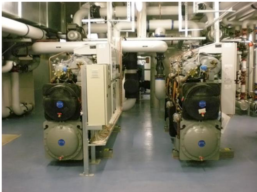
Abbildung 10: Heizzentrale des Wohnquartiers Vézenaz Sud-Ouest (Quelle E.C.M. SA).
