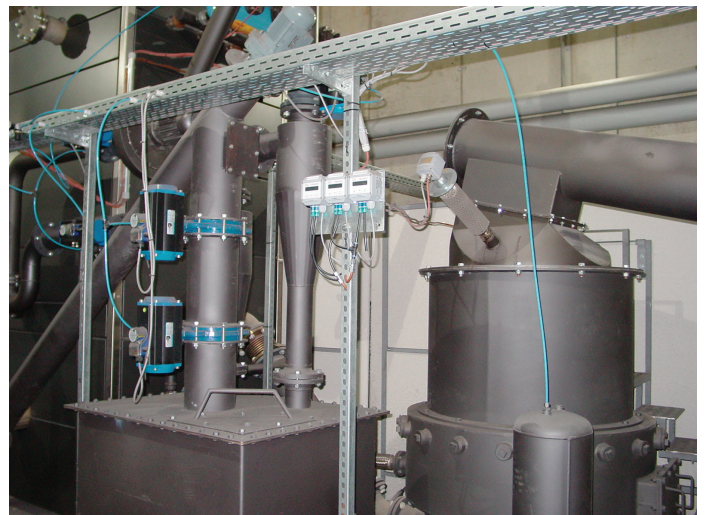
Blick auf die Holzvergasungs-Anlage bei der Josef Bucher AG in Escholz matt (LU): Im runden Vergaser rechts entsteht das Holzgas. Foto: Josef Bucher AG
