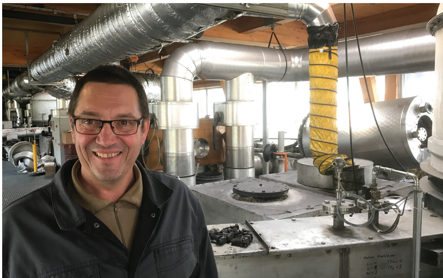
Betriebsleiter Hans Bieri produziert mit der Holzvergasungs-Anlage in Stans pro Jahr 10,2 GWh Wärme, die einen Wärmeverbund mit 60 Wohnungen und 20 Industrie- und Gewerbebetrieben versorgt. Dazu speist die Anlage jährlich 5,6 GWh Strom ins Netz. Foto: B. Vogel
