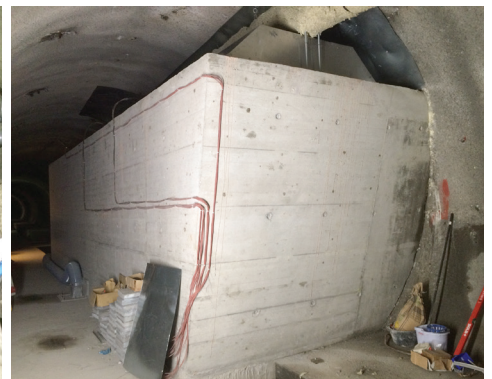
Eine mit Steinen gefüllte Betonwanne dient beim Tessiner Experiment als Wärmespeicher. Fotos: ALACAES
