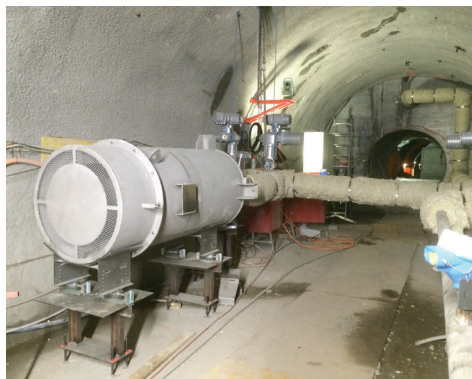
Schalldämpfer, der beim Entladen der Felskaverne die ausfliessende Luft abkühlt und abdämmt.
