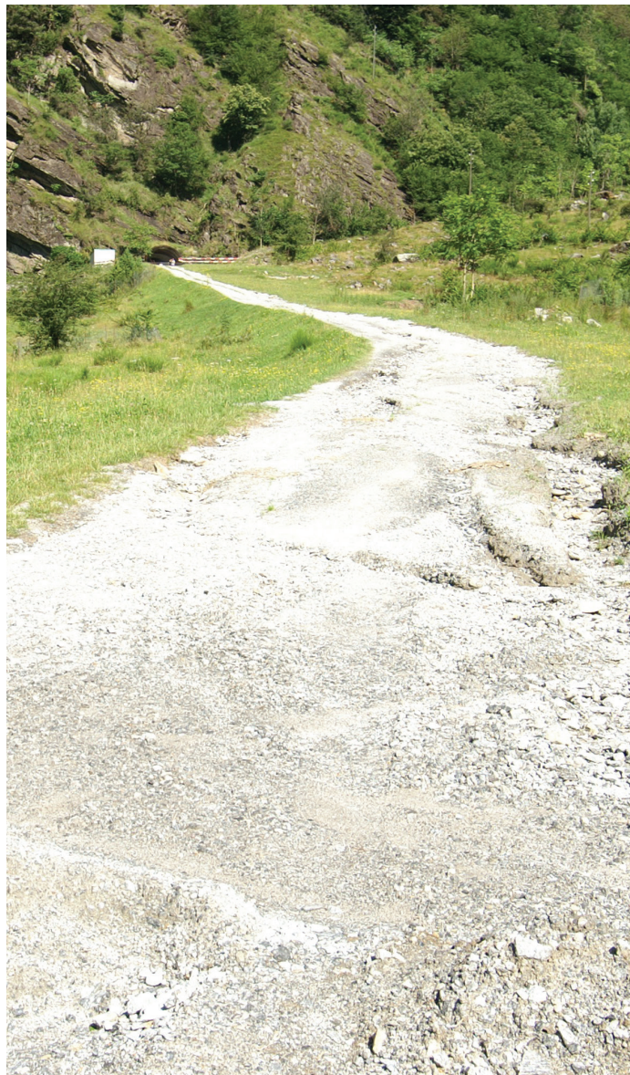
Zugangsstrasse zum Felsstollen im Bleniotal, in dem die Firma ALACAES im Herbst 2016 Komponenten eines Druckluftspeichers getestet hat. Foto: B. Vogel
