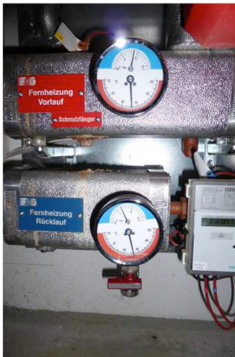
Bild 5.20 Vor- und Rücklauftemperatur der Primärseite der Fernwärmeübergabestation Rosenweg 9 mit jeweils 73^\circ\text{C} , also einem \Delta T von 0 K und einem momentanen Durchfluss von 1.0 \text{ m}^3/\text{h} .
