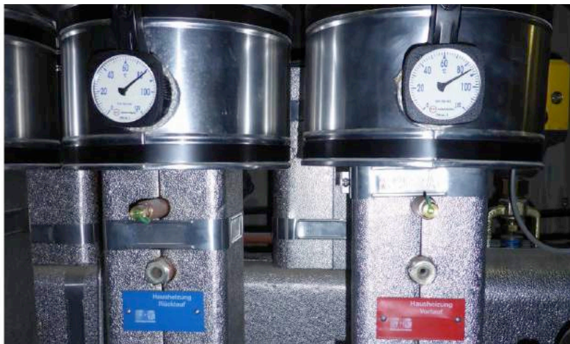
Bild 5.8 Vor- und Rücklauftemperatur der Sekundärseite der Fernwärmeübergabestation AVARI mit 83°C bzw. 80°C, also einem \Delta T von 3K.
