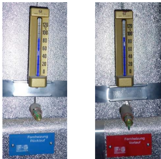
Bild 5.7 Vor- und Rücklauftemperatur der Primärseite der Fernwärmeübergabestation AVARI mit 94°C bzw. 88°C, also einem \Delta T von 6K und einem momentanen Durchfluss von 13.2 m 3 /h.
