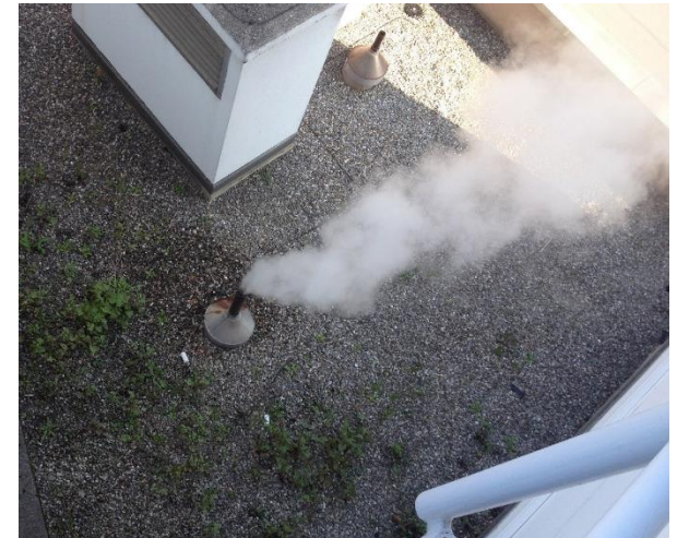
Entspannungsdampf vom überhitzten Kondensat
