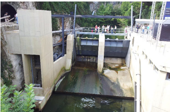
Fischaufstieglift beim Kraftwerk Moulinets in Orbe VD (Foto Mhylab)
