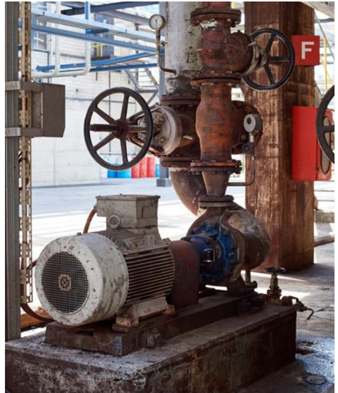
Pumpen älteren Baujahrs verbrauchen oft unnötig viel Energie.
