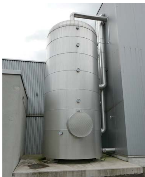
Die Abwärme aus der Druckluft erwärmt – mit einem hohen Temperaturniveau von 60 bis 90 °C – den 30 000-Liter-Wärmespeicher konstant das ganze Jahr.
