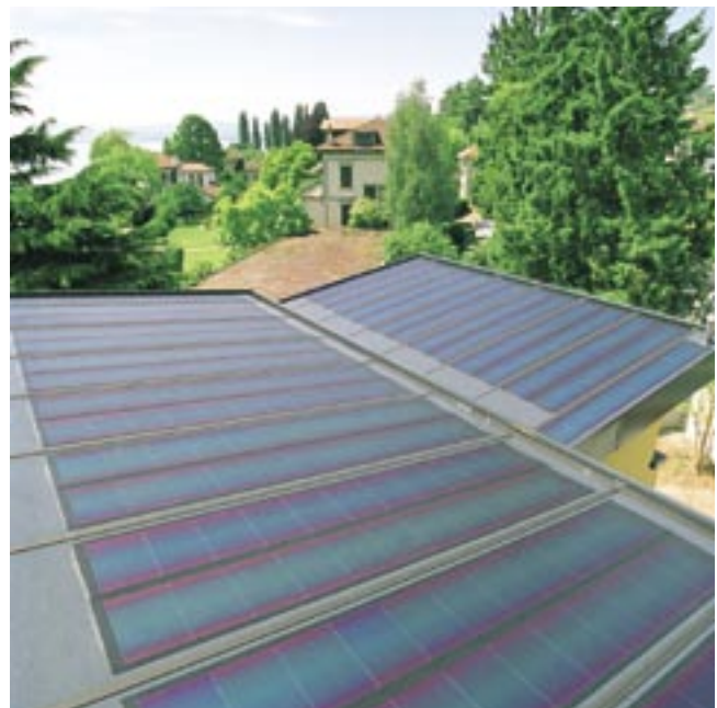
Regendicht ohne äussere Glasabdeckung ist das Solardach einer Villa in Lutry am Genfersee. (Bild Frédéric Paschoud)
