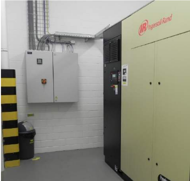
Einspeisung mit Energie- messung
