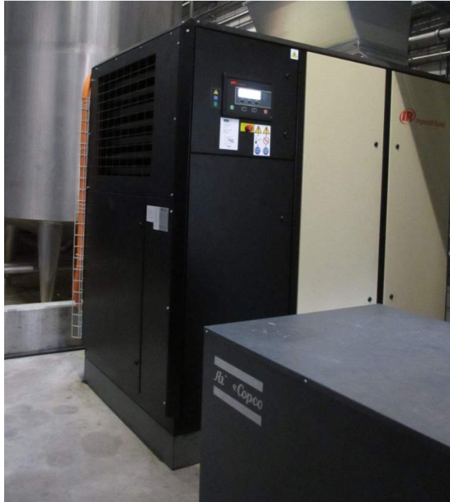
Frequenz geregelter mit Permanentmagnetmotor ausgerüsteter Druckluftkompressor 90 kW Ingersoll Rand Nirvana
