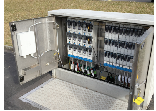
Die Gridbox, hier in einem Verteilkasten eingebaut. Foto: SCS
