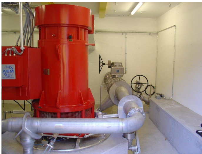
Maschinenhaus von Arbaz II: Turbine / Generator mit Bypass und Druckreduktionsventil (Quelle: Gasa Hydro SA)
