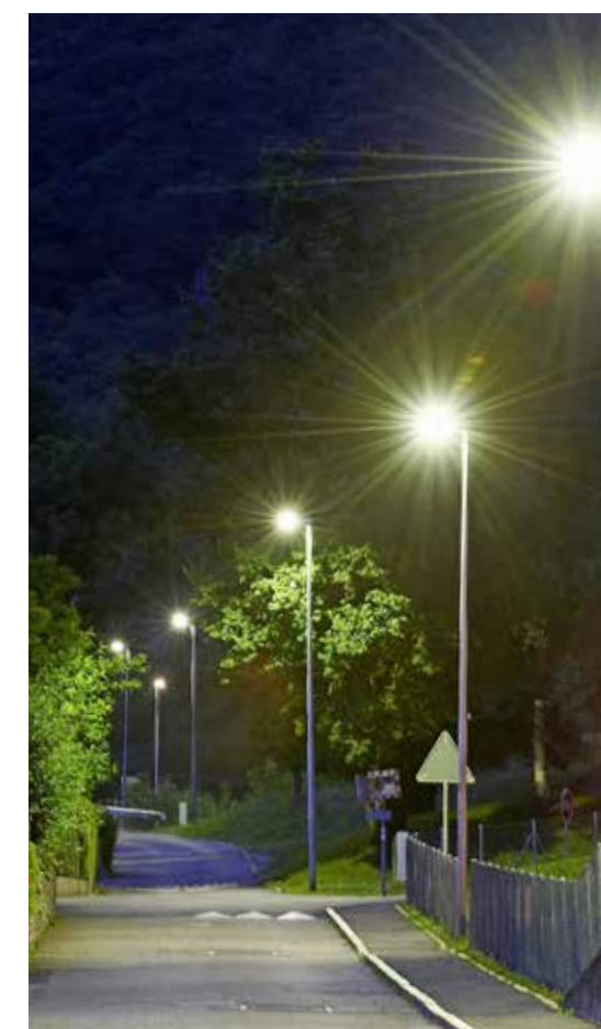
Wechsel zu LED: Luminos Strassenbeleuchtung braucht jetzt zwei Drittel weniger Strom.
