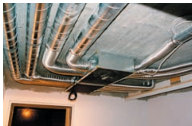
Zu- und Abluftkästen in der heruntergehängten Decke eines Wohnvorraums.
