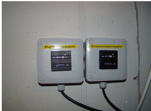
Abb. 3: Betriebsstunden- und Schaltimpulszähler für Kompressor und Zusatzheizung
