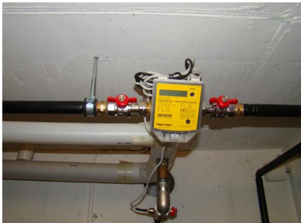
Abb. 2: Wärmezähler in Kaltwasserzuleitung und zweiter Fühler in Warmwasserleitung
