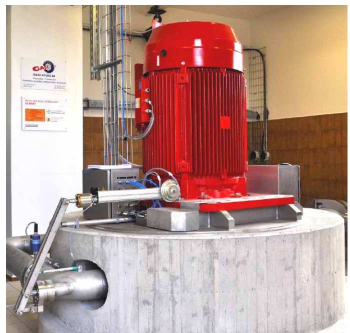
Die neue Pelton turbine des Kraftwerks Brent ( Q = 84 \text{ l/s} , H = 122 \text{ m} , P_e = 80 \text{ kW} , E_e = 380'000 \text{ kWh/a} ) (Foto: Romande Energie)
