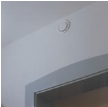
Zuluftöffnung in einem der Wohnzimmer.
