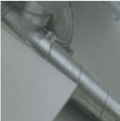
Blick in das Reduit mit dem Lüftungsgerät.
