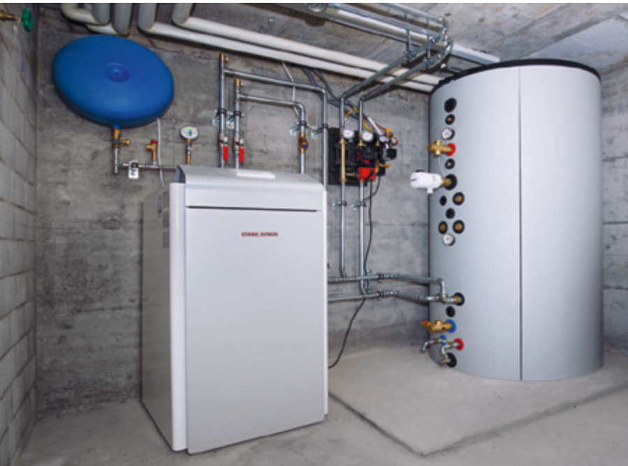
Ein paar Tage später ist die neue Wärmepumpe installiert und betriebsbereit.
