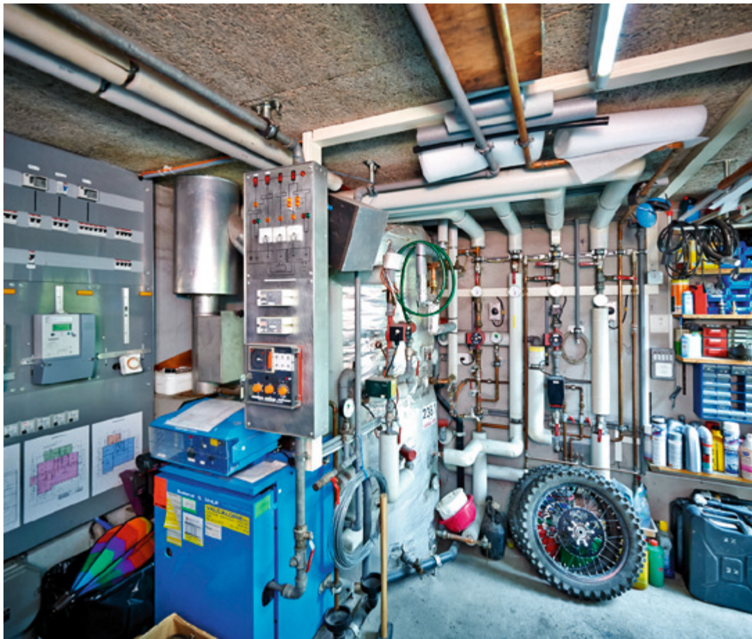
Keller der Familie Roh: Hier laufen die Steuergeräte der energieeffizienten Gebäudetechnik zusammen.
