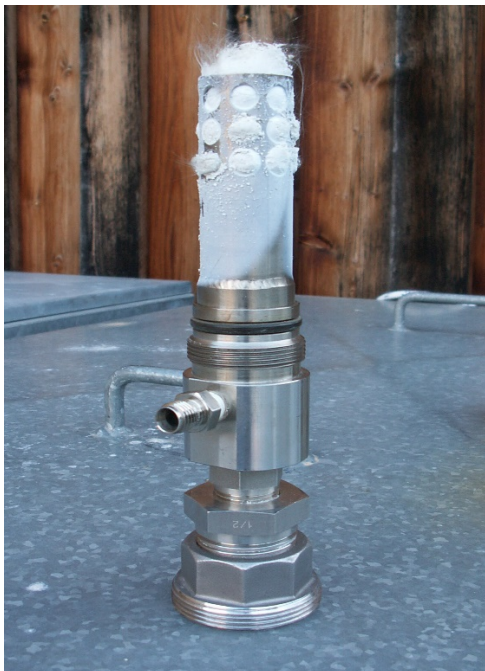
Filter der beheizten Sonde einer guten Anlage (weiss)
