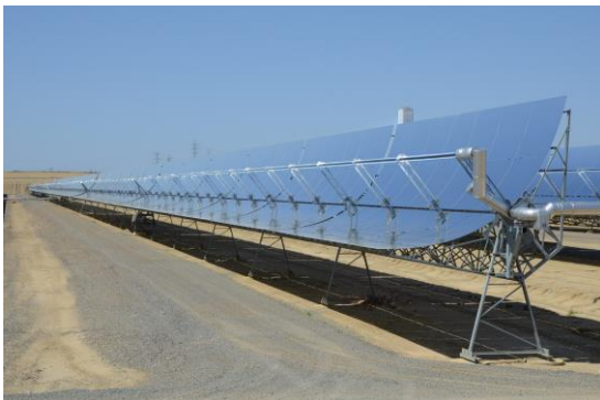
Bild 1: Konzentrierendes Solarkraftwerk in Sevilla, Spanien (Foto: Marc Muller)
