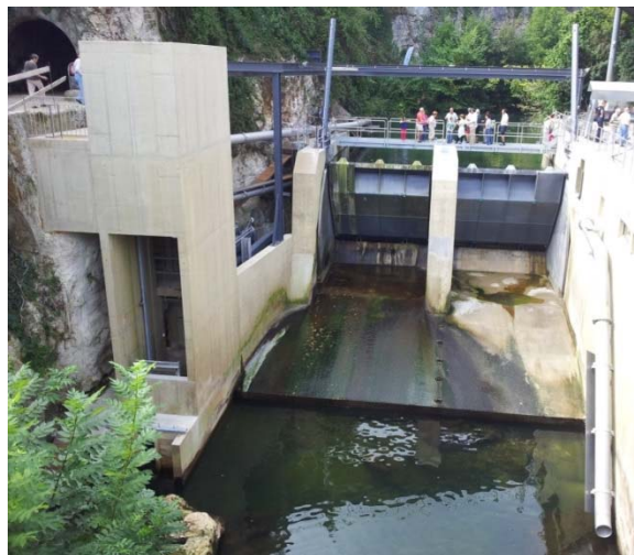
Kleinwasserkraftwerk Moulinets in Orbe (VD), mit Biberrampe, Fischlift, beweglichen Wehrklappen und dem Maschinenhaus 18
