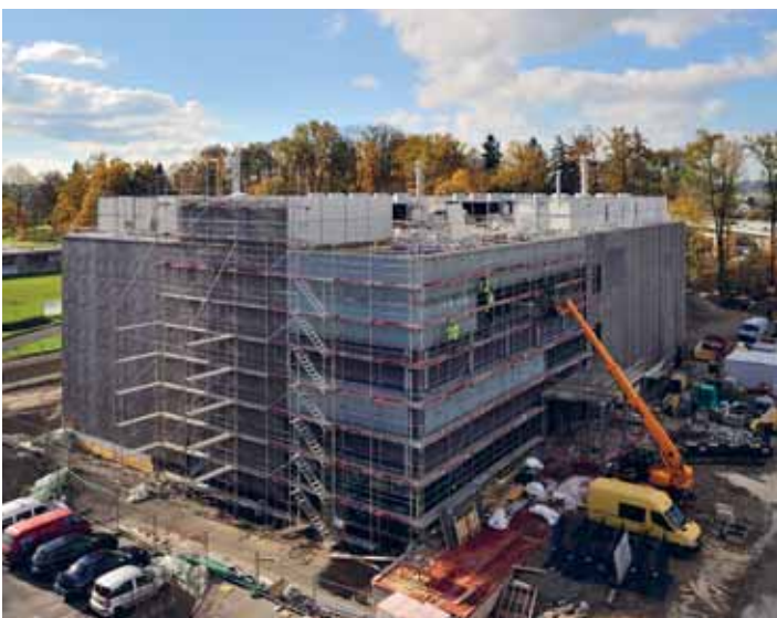
Abbildung 207: Bern Wankdorf Rechenzentrum Swisscom. Aussenluftkühlung mit Hybridkühlern. Erstes Kältemaschinenfreies Rechenzentrum. Konzept: Dr. Eicher und Pauli AG (Dr. Eicher+ Pauli AG).
