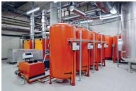
Abbildung 111: Um die Ausdehnung des Wassers bei verschiedenen Temperaturen aufnehmen zu können, benötigt eine solche Anlage Expansionsgefässe (ewz).
