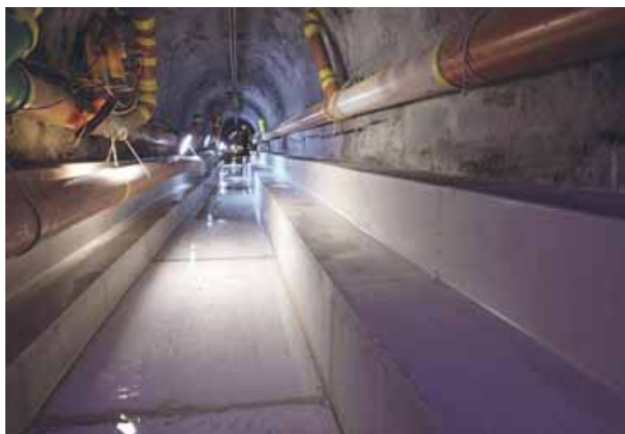
Abbildung 14: Abwasserkanal am Hirschengraben mit Wärmetauschern in der Abwasserrinne (ewl).
