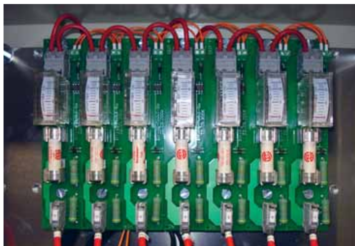
Abbildung 49: Gleichstromsicherungen und Mess- anzeigen in einem Generatoranschluss- kasten (Basler & Hofmann AG).
