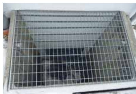
Abbildung 94: Luftansauggitter über einem Licht- schacht.
