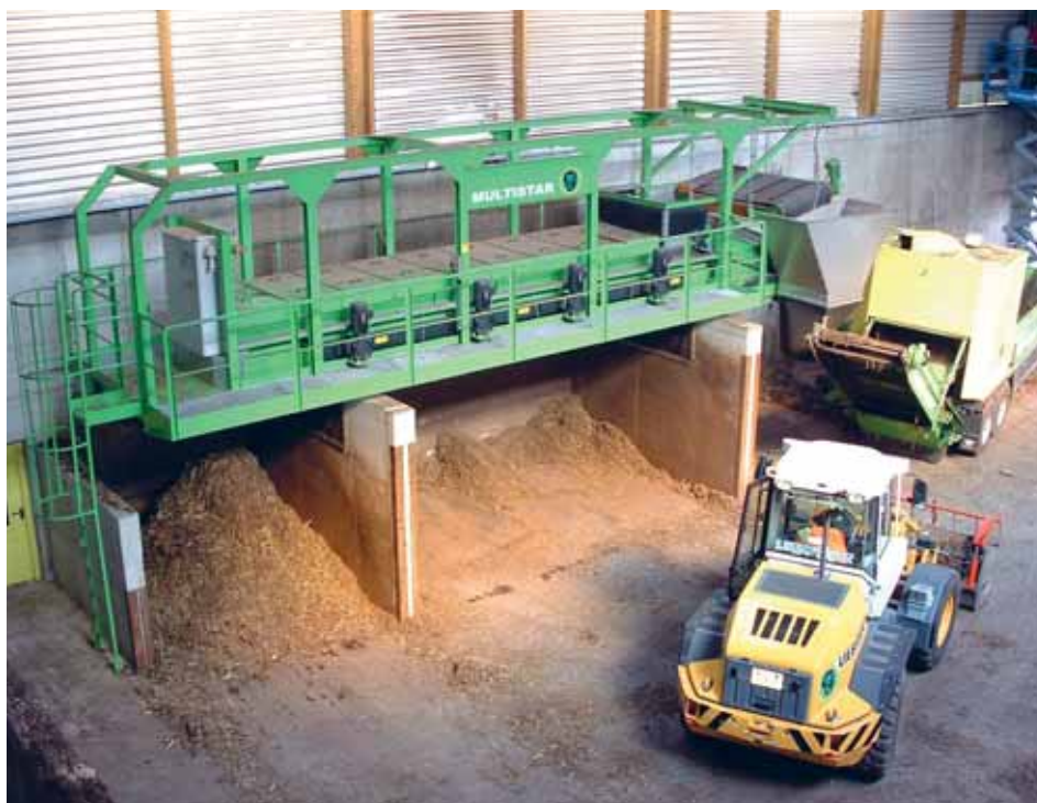
Abbildung 171: Biopower-Anlage Pratteln – Annahmehalle.
