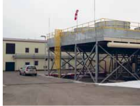
Abbildung 194. Geothermiekraftwerk Insheim: Luftkühler und Betriebsgebäude.
