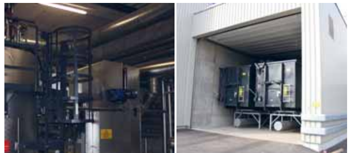
Abbildung 151: Für einen Lebensmittelproduktionsbetrieb angepasstes Brennstofflager mit zwei Wechselcontainern und einem Rolltor. Mit dieser Lösung können die durch den Holzumschlag verursachten Staub- und Geruchsemissionen auf ein Minimum reduziert werden.
