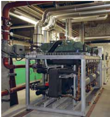
Abbildung 103: Kombinierte Wärmepumpen/ Kältemaschinen im Coop-Verteil- zentrum Bern (Dr. Eicher + Pauli AG).
