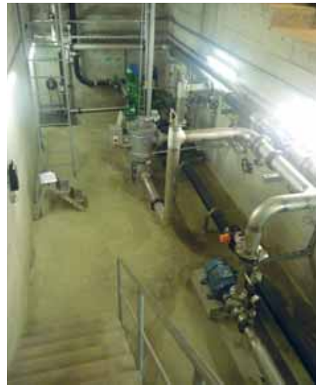
Abbildung 114: Fabrikwasserversorgung mit Filter.
