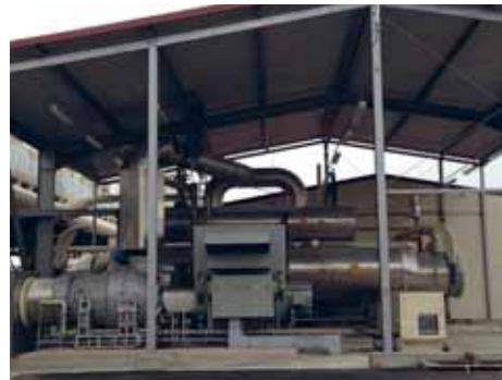
Abbildung 195. Geothermiekraftwerk Insheim mit ORC-Verfahren: Turbine und Generator, dahinter Röhrenwärmetauscher und Verdampfer. ORC = Organic Rankine Cycle
