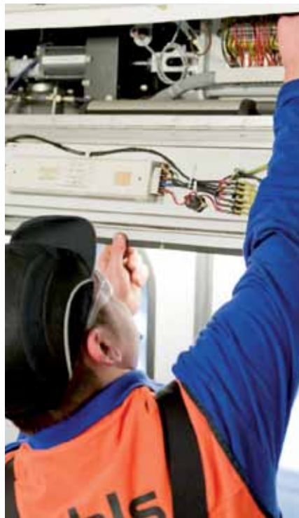
Mit einem neuen Forschungsprojekt sollen integrale Konzepte für die thermische Gestaltung der Bahnwagen und der elektrischen Installationen entwickelt werden.
