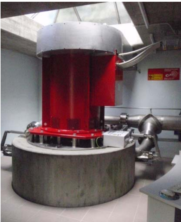
Zweidüsige Pelton-Turbine und Generator des Trinkwasserkraftwerks La Rasse, mit einer Leistung von 750 kW
