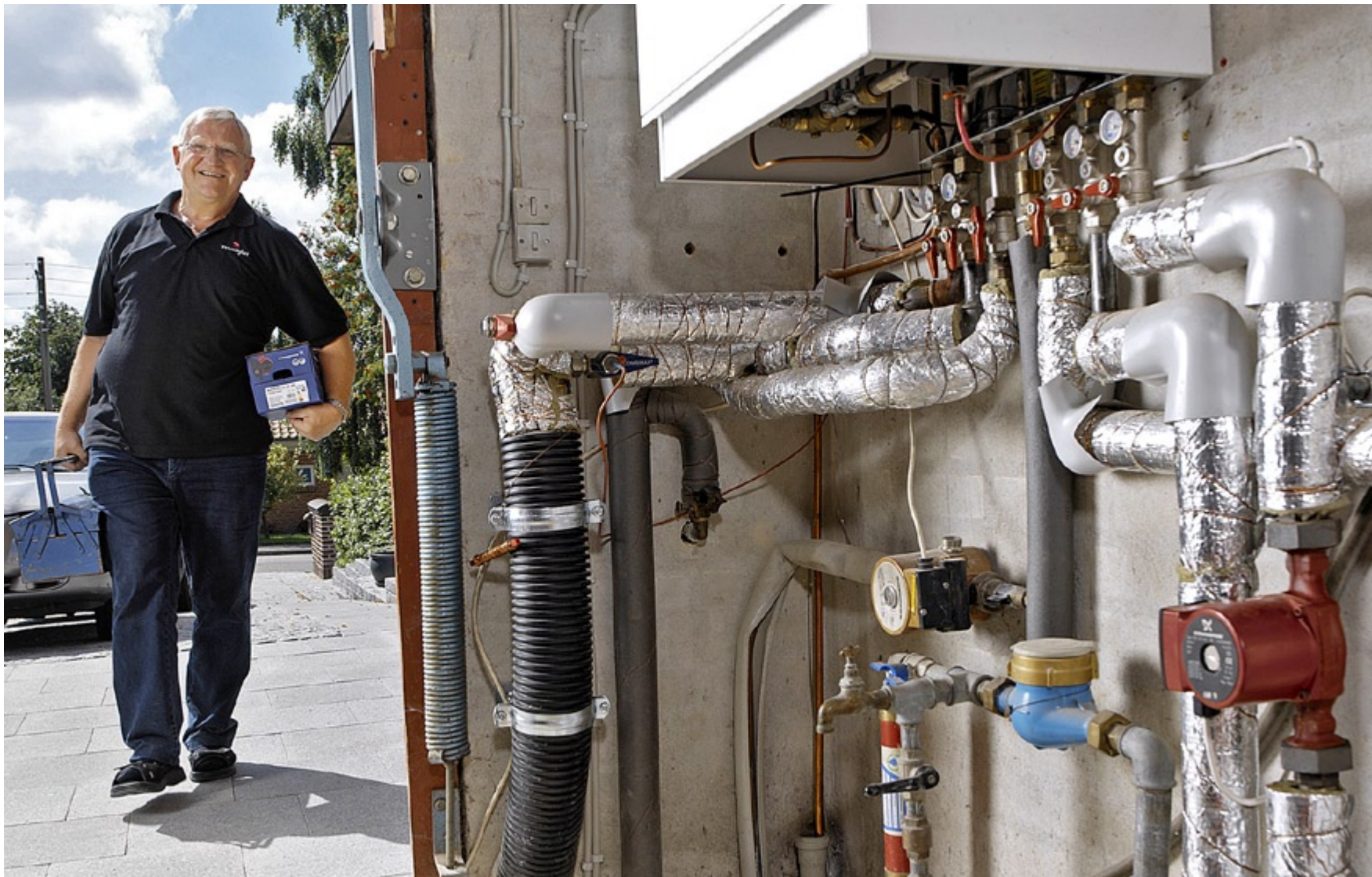
Alte Umwälzpumpen sind oft überdimensioniert und sollten durch ein leistungsfähigeres Gerät der Effizienzklasse A ersetzt werden. Gleichzeitig könnte man die Verteilleitungen richtig dämmen.
