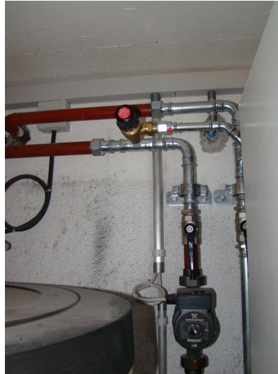
Fotos: Zwei Beispiele nicht isolierter Heizleitungen
