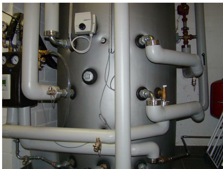
Beispiel einer komplizierten Einbindung, welche einen Verlust an Energieeffizienz verursacht
