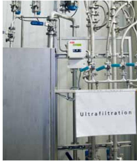
Die Ultrafiltration findet in diesen Röhren (rechts im Bild) statt und scheidet die inaktiv gewordenen Bestandteile aus.
