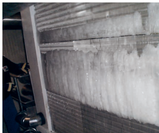
Bild: Vereister Verdampfer. Nur noch ein Teil der Fläche wird von Luft durchströmt.
