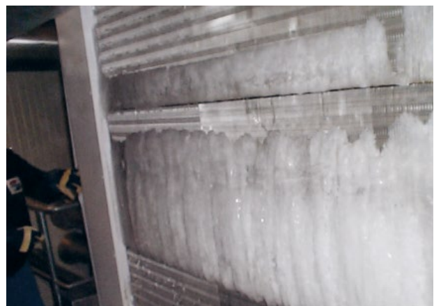
Bild: Vereister Verdampfer. Nur noch ein Teil der Fläche wird von Luft durchströmt.
