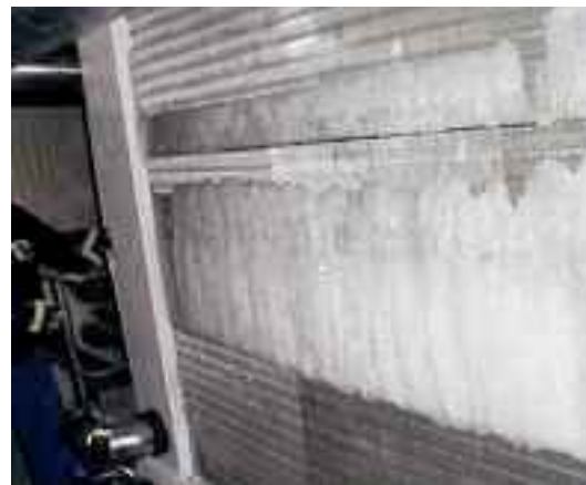
Bild: Vereister Verdampfer. Nur noch ein Teil der Fläche wird von Luft durchströmt.
