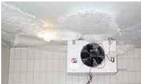
Bild: Vereisungen an Decke und Wand
