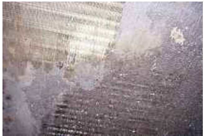
Bild: Verschmutzter Luftkühler, die Lamellen verschliessen sich langsam.
