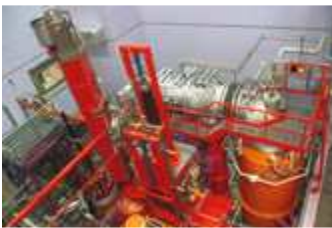
Plasma-Anlage in der Ofenhalle im zentralen Zwischenlager ZWILAG. Ein Teil der schwach- und mittelaktiven Abfälle wird in dieser Verbrennungs- und Schmelzanlage verglast. Quelle: ZWILAG
