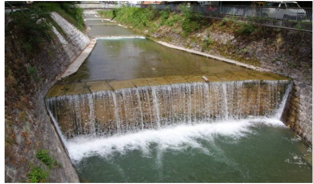
Beispiel eines stark beeinträchtigten Fließgewässers: Die Veveyse in Vevey
