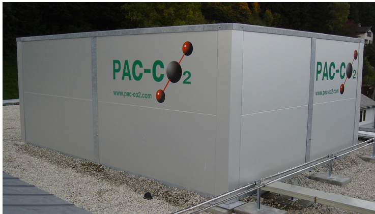
Figure 1 : Pompe à chaleur sur le toit.
