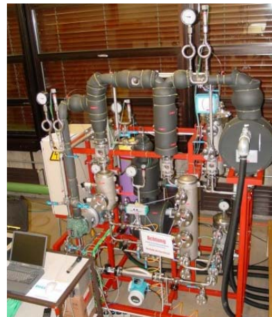
Bild 4: Versuchsanlage einer Ammoniakkleinwärmepumpe an der FH Rapperswil [3]
