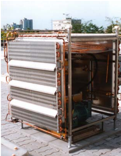
Bild 5: Wärmepumpe mit „stillem Verdampfer“ an der FHBB in Muttenz. [4]
