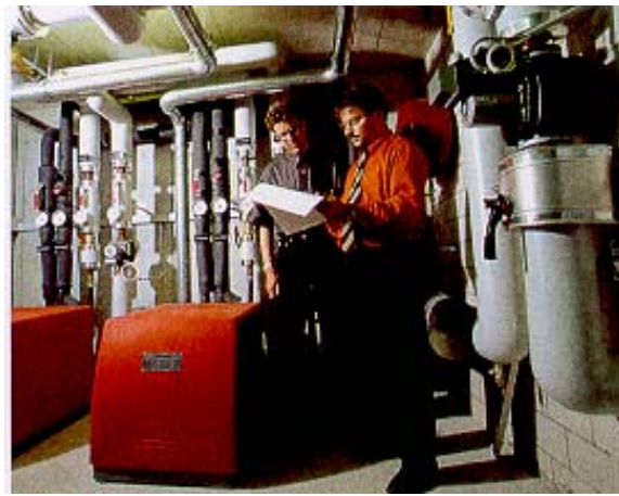
Bild 10: Heizzentrale für alle 31 Einfamilienhäuser.
