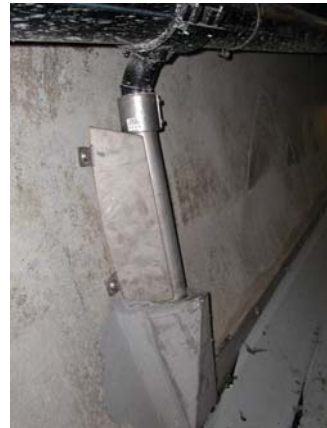
Bild 7: Detail der Anschlussleitung auf den Wärmetauscher.
