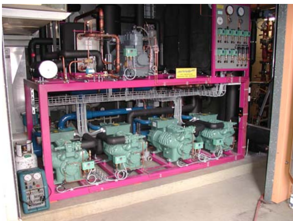
Bild 8: Die Wärmepumpe mit 320 kW Leistung.
