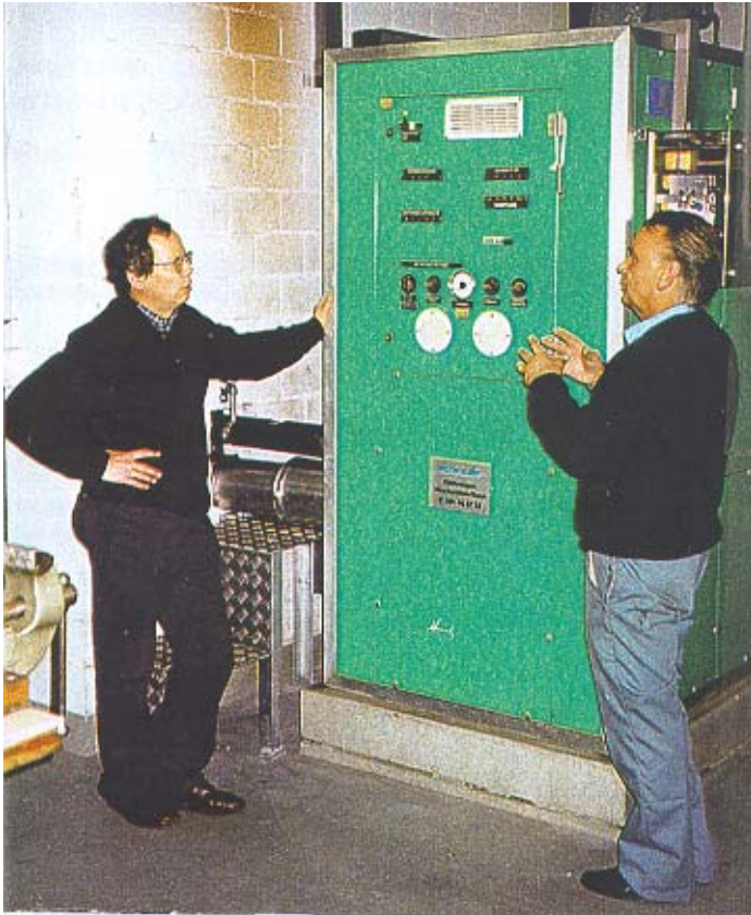
Bild 13: Seit 20 Jahren wird ein Garderobengebäude dank dieser Wärmepumpe mit Abwasserwärme aus dem nahen Kanal beheizt, gemäss dem verantwortlichen Hauswart sehr wartungsfreundlich.
