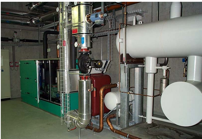
Bild 3: Wärmepumpe Berufsschulen Bern-Lorraine mit überflutetem Verdampfer (rechts).
