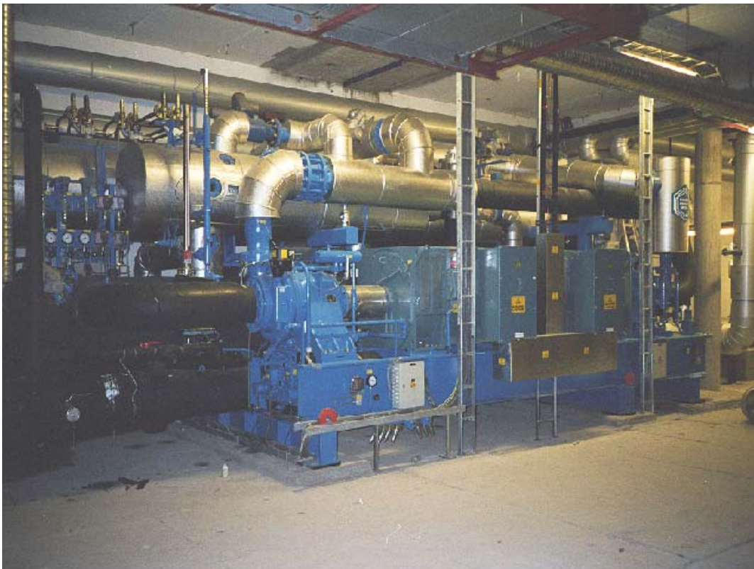
Bild 3: Typische zweistufige Kälteanlage mit Wärmerückgewinnung.
