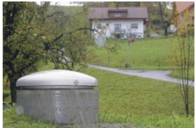
Einstieg zum Trinkwasserkraftwerk Niederhünigen.
