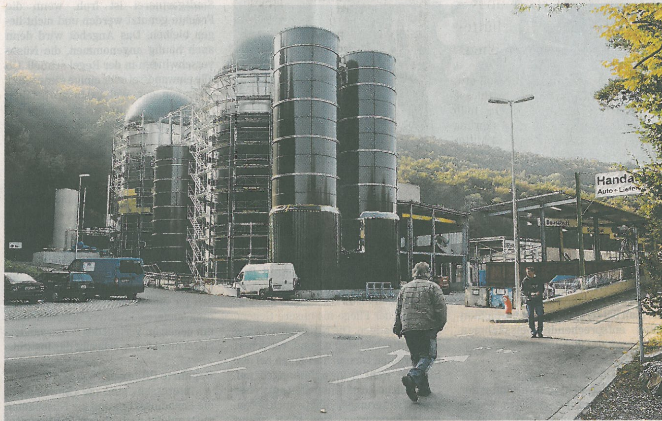
Cape Canaveral in Beringen? Die neue Biogasanlage soll im März den Betrieb aufnehmen.
