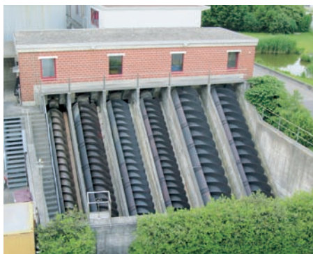
Bei Abwasserkraftwerken wird das Gefälle vor oder nach der ARA zur Stromgewinnung genutzt.
