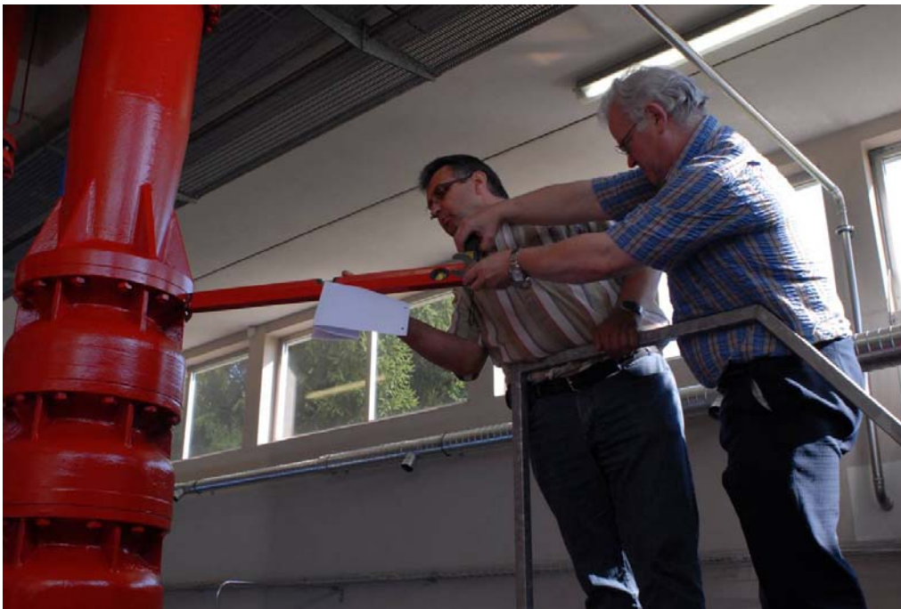
Abbildung 8: Eichung der Höhe Pumpenaustritt
