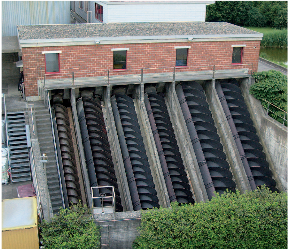
Die Abwasserreinigung erfordert einen hohen Energieeinsatz.
