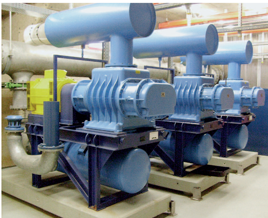
Der Ersatz der abgebildeten 35-jährigen Gebläse für die Biologie durch neue Aggregate mit Leistungsregulierung brachte beträchtliche Energieeinsparungen.
