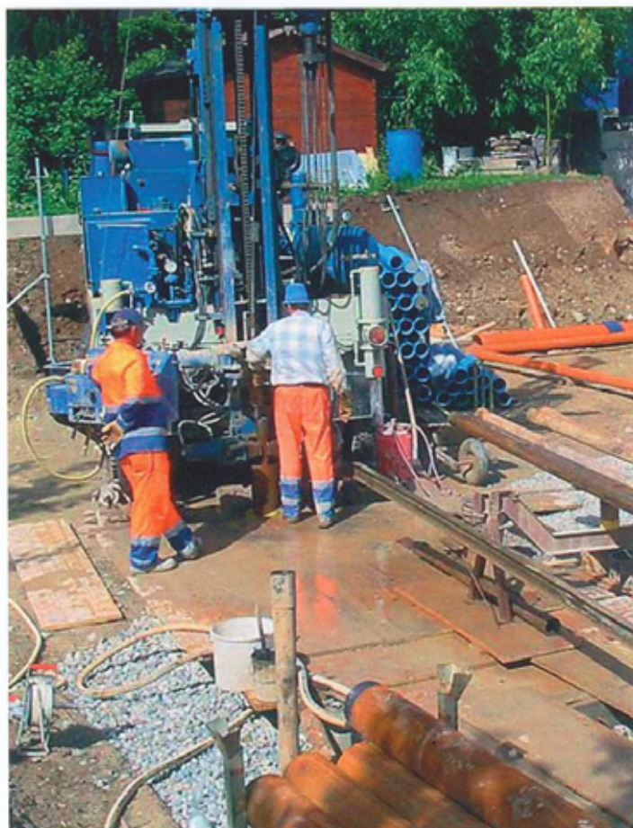
Beim Rückgabebrunnen der mit Grundwasser betriebenen Wärmepumpen-Anlage wurde eine umgebaute Pumpe als Turbine eingesetzt. Damit kann ein Teil der nötigen Elektrizität fürs Pumpen bei der Rückgabe wiedergewonnen werden. Fotos Eberhard & Partner AG
