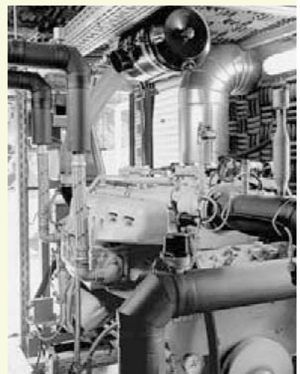
Im Blockheizkraftwerk werden aus Biogas Wärme und Strom erzeugt.
