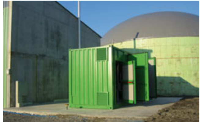
Fermenter und Biomethananlage der Rhy Biogas AG in Widnau.
