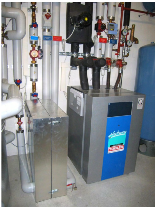
Abbildung 5: Wärmepumpe (rechts) und aussenliegender Plattenwärmetauscher (links)
