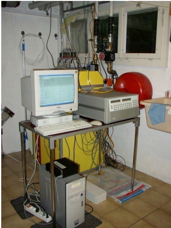
Bild 6: Messanlage im Haus A
