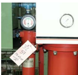
Abb. 6: Markierung einer Leckagestelle an einem Filter
