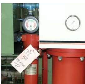
Abb. 6: Markierung einer Leckagestelle an einem Filter
