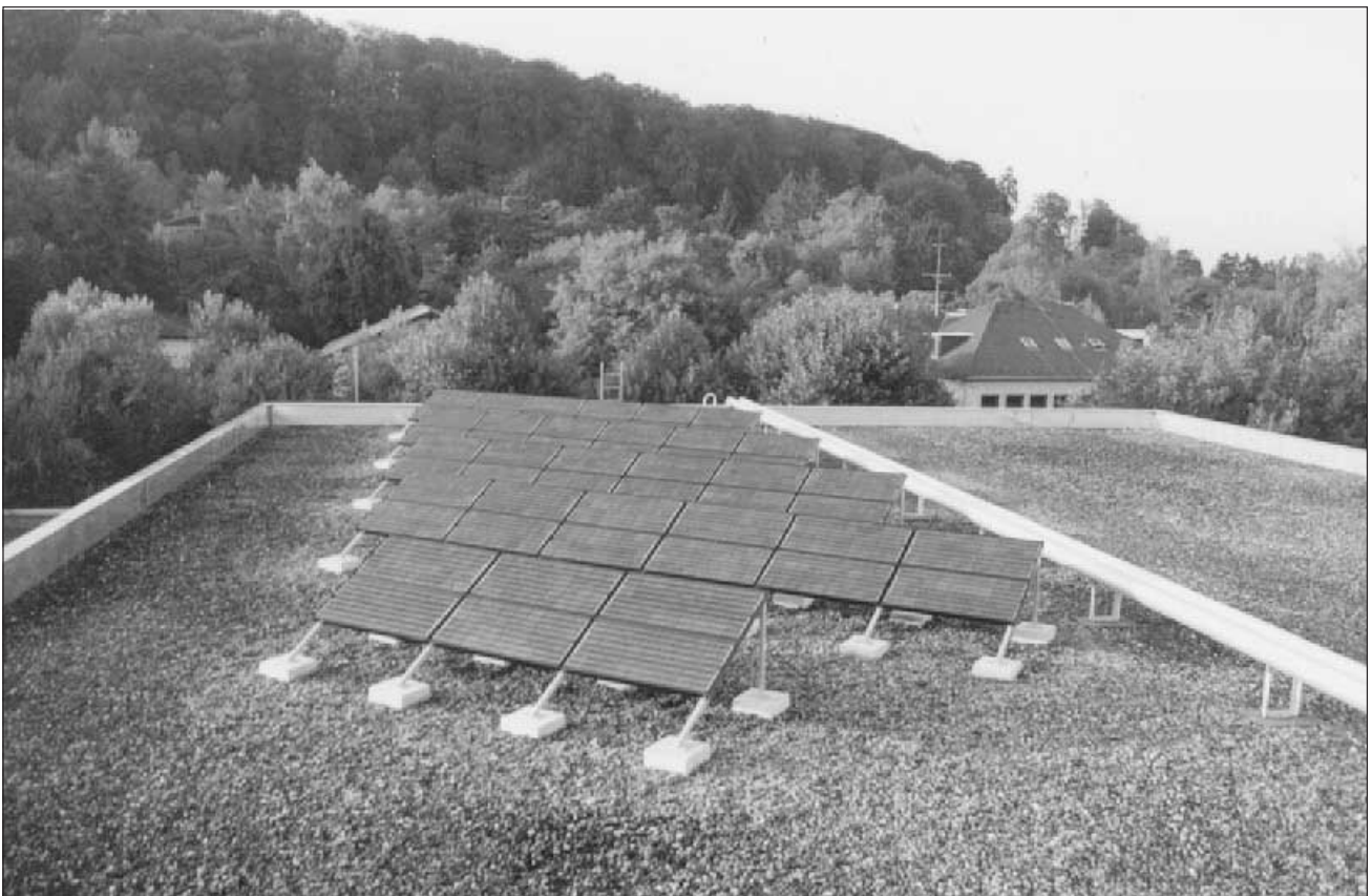
3,2-kW-Anlage in Zürich mit Schwerlastverankerung
