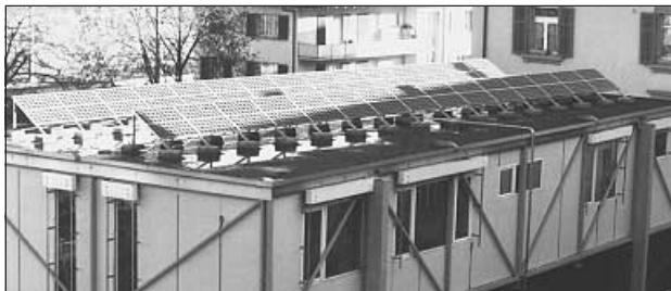
Teilbeschattung einer 3-kW-Flachdachanlage.
