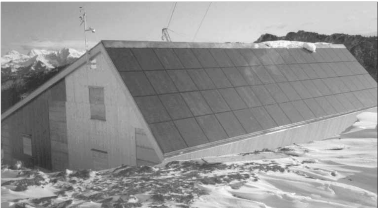
13-kW-Photovoltaik-Dach der Alphütte Alp Findels
