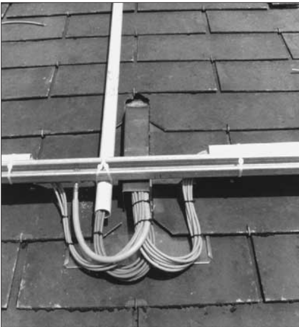
Dacheinführung der Kabel des Solarzellenfeldes
